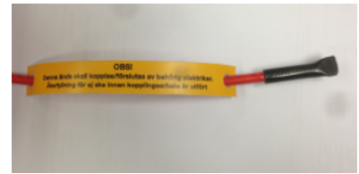
Kabelände utan ändavslut (gjutbox)
